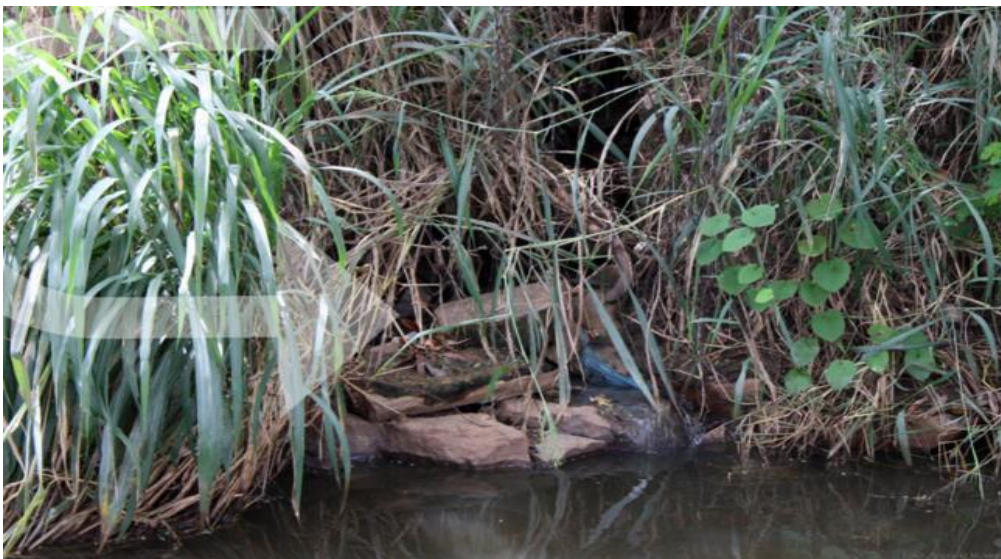
Figura 05 – Detalhe de uma boca de manilha por onde sai o esgoto direto. Também clandestino.
